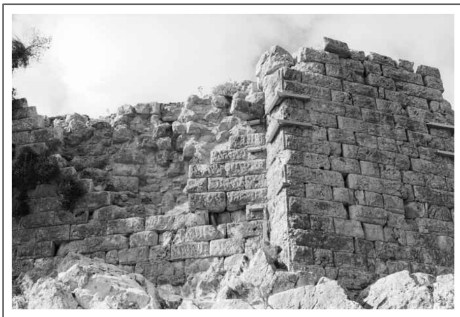
Η Ανατολική πλευρά του Τείχους με τις φθορές από το σεισμό και τα πρόχειρα προστατευτικά μεταλλικά ελάσματα στον αμυντικό πύργο. Φωτο: Δ. Γ., 2003.
